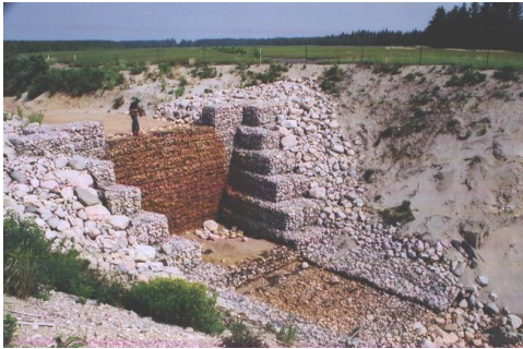
Talus en érosion
